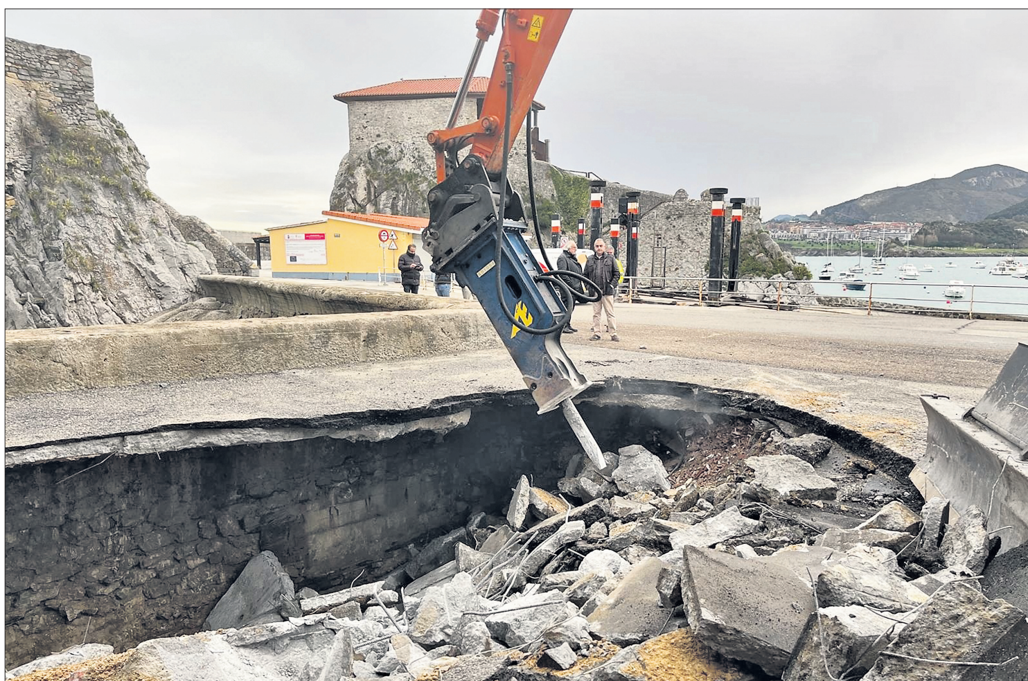
El Gobierno de Cantabria implementó un vallado en la zona afectada para proteger a los usuarios y trabajadores. / ALERTA
