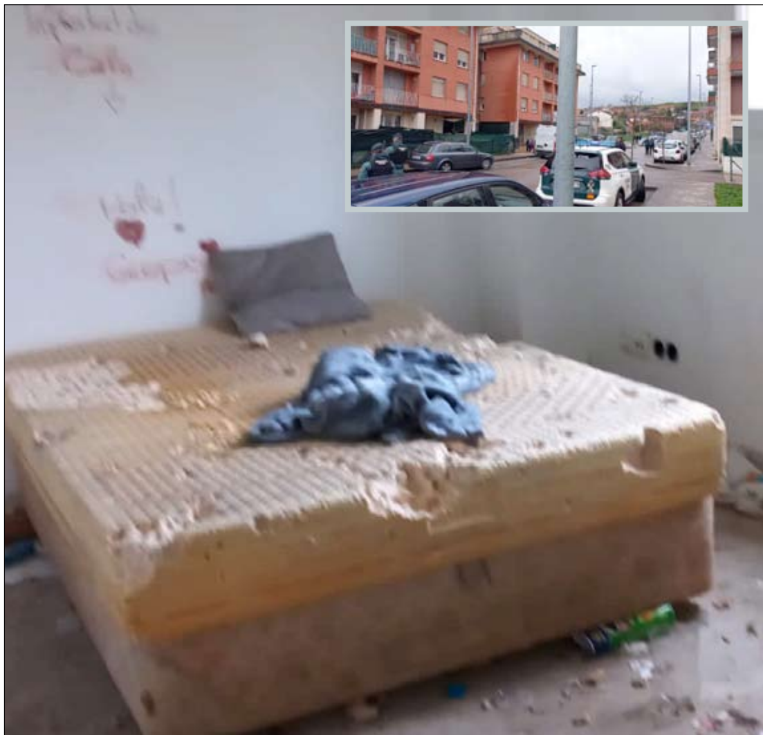
El edificio se encuentra en unas condiciones que impiden ser habitado. / ALERTA
