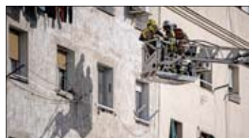
Bomberos tras el derrumbe. / L.S.
